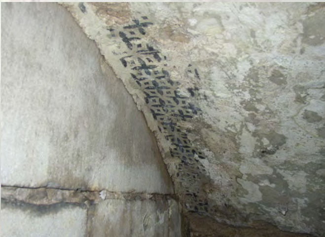
Cathédrale de Toul, décor peint encore en partie visible en 2007, sur la voûte du caveau de la chapelle « du Jeudi Saint », cl. V. Lamarque, 26 juillet 2007.
